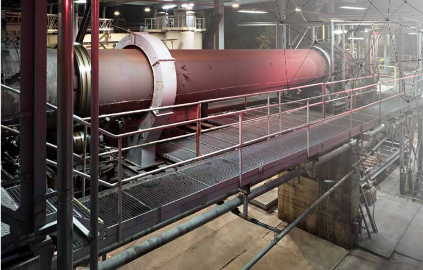
Die thermische Behandlung für Recyclingprozesse erfolgt im IBU-tec-Drehrohrföfen.
